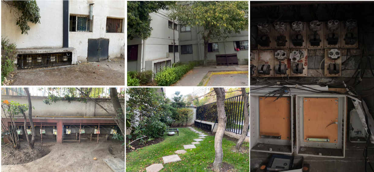
Figura 2. Dispositivos de contabilidad de aguas, gas y electricidad en edificios colectivos de vivienda Fuente: Fotografías tomadas por el autor en el marco de las observaciones etnográficas
